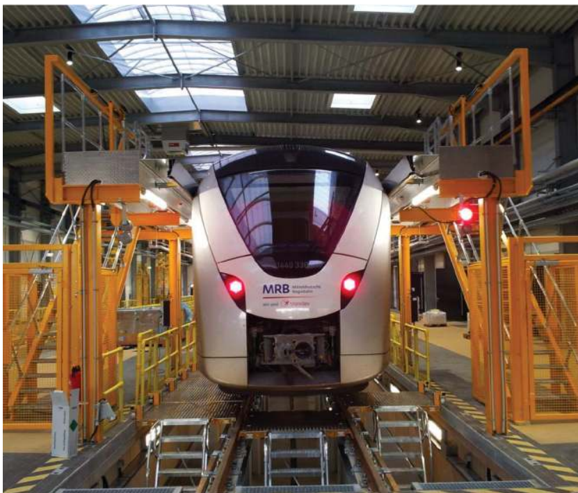
Raised roof access platforms / Erhöhte Dacharbeitsplattformen
